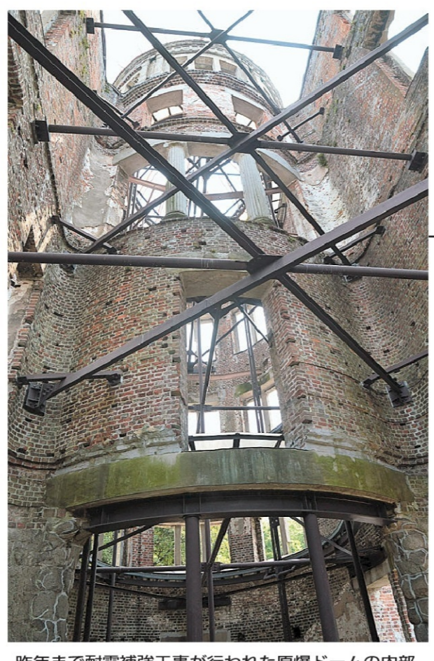
昨年まで耐震補強工事が行われた原爆ドームの内部。7月下旬、広島市中区。
